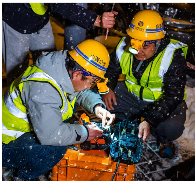
中国移动在山西太原杏花岭区风雪天的光缆故障抢修现场
